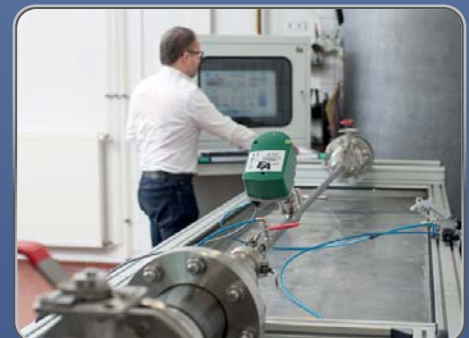
Unser moderner Prüfstand ermöglicht Durchflussmessungen nach DIN EN 60534 bis 200m³ Wasser pro Stunde. Our modern test rig allows flow measurements conform with DIN EN 60534 up to 200m³ of water per hour.
